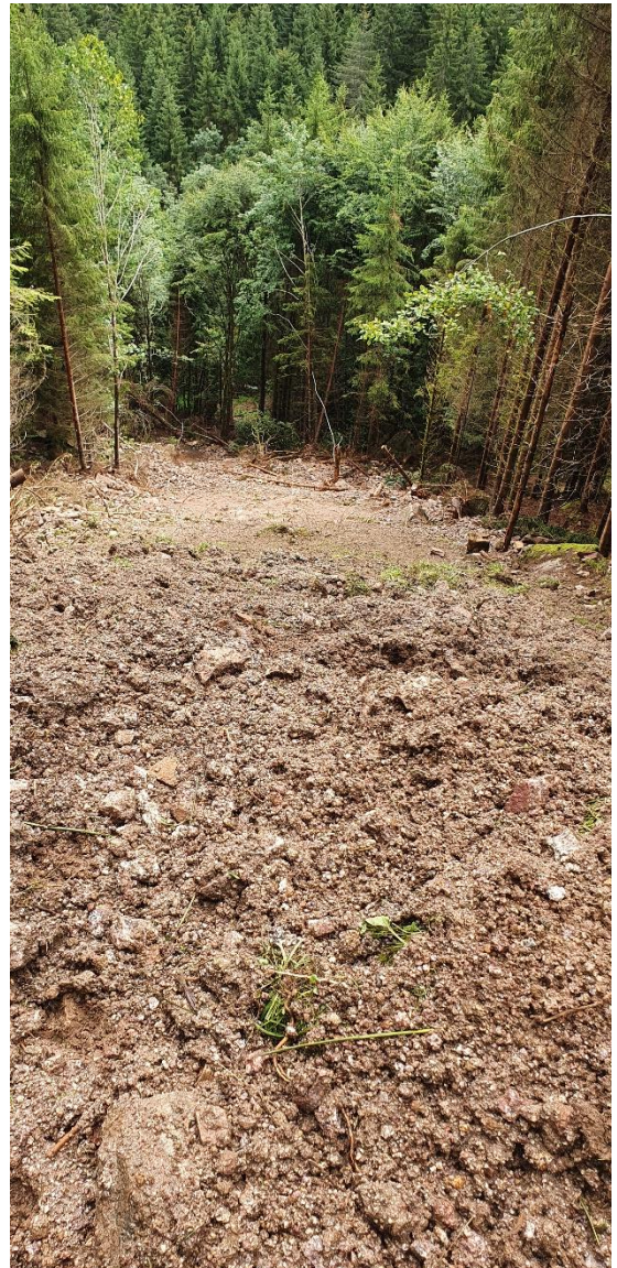
Abbildung 20: Hangrutsch unterhalb des betroffenen Wegeabschnitts (Blick vom Weg talabwärts; Hof Bolkart)
